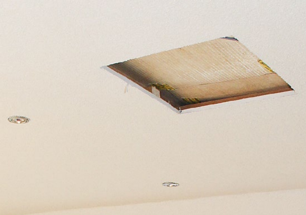
Deckenintegriertes VH-I Heizelement im Alt- und Neubau.
