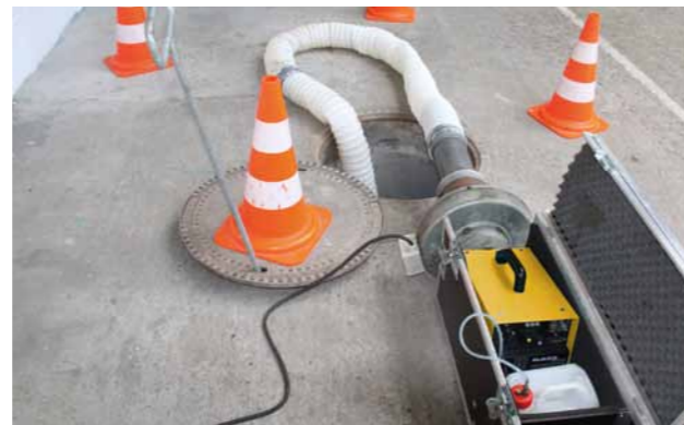
Gerätetechnik für Vernebelungsanlage
