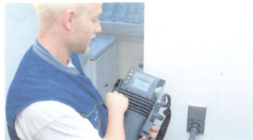
Markus Greulich überprüft elektrische Anlagen.
