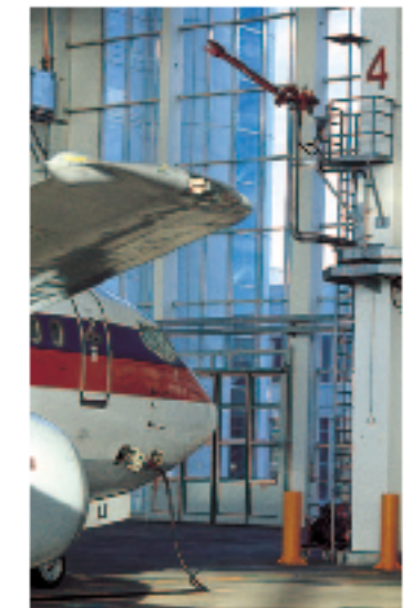
Installiert für schnelle Hilfe: Schaum-/Wasserwerfer in einer Wartungshalle
