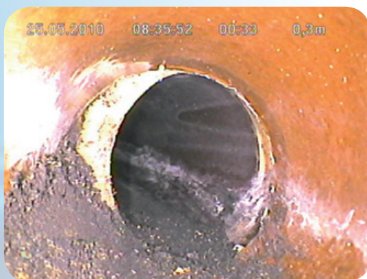
Muffenverschiebung mit eindringendem Erdreich
